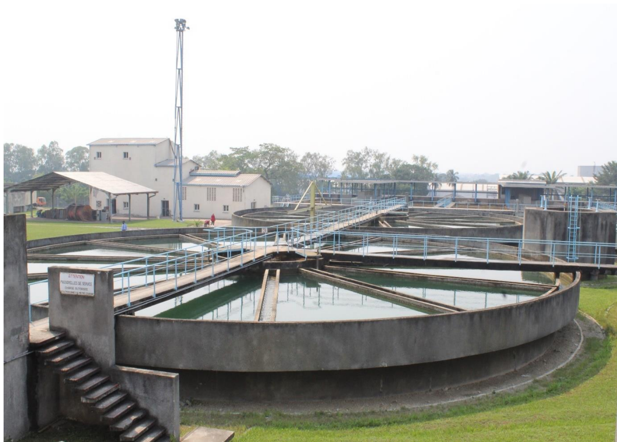
Aperçu de l'Usine de production d'eau potable de N'djili/Kinshasa
