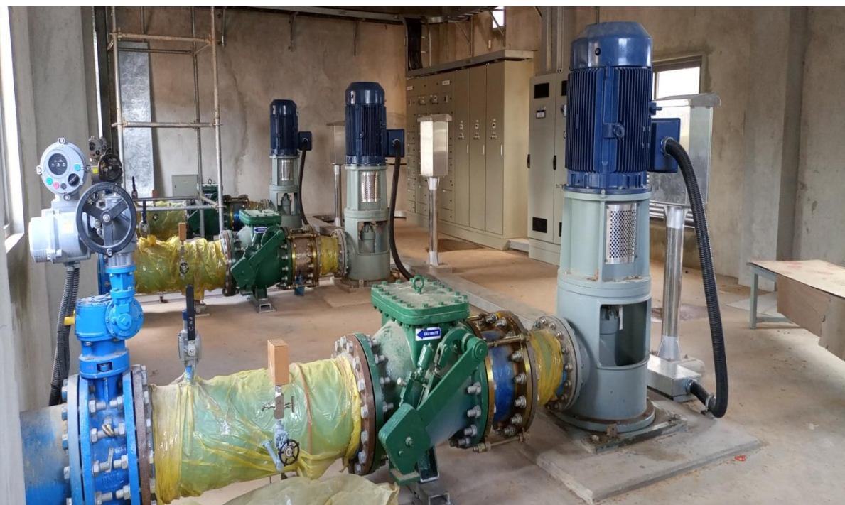
Les Groupes Motopompes installés à la nouvelle Usine de Lemba-Imbu.
